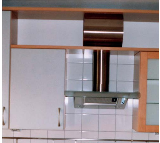
Umlufthaube in einer Küche
