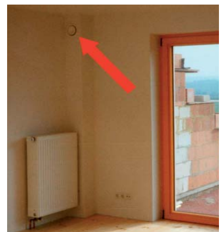
Zuluftventil über einem Heizkörper
