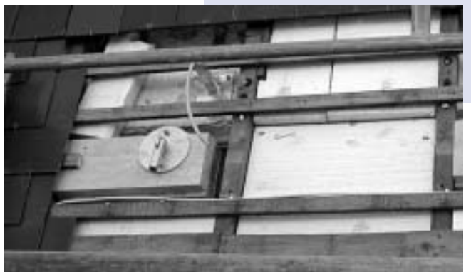
So sieht es leider oft hinter älteren Vorhangfassaden aus: Viel zu dünne Dämmplatten mit großen Fugen bilden einen eher symbolischen Wärmeschutz.
