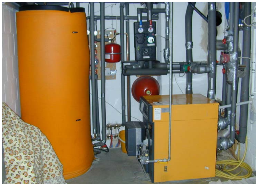
Geeigneter Aufstellungsort für den Speicher ist meist der Heizungskeller – der Anschluss des Heizkessels für die Nachheizung ist leicht möglich.
