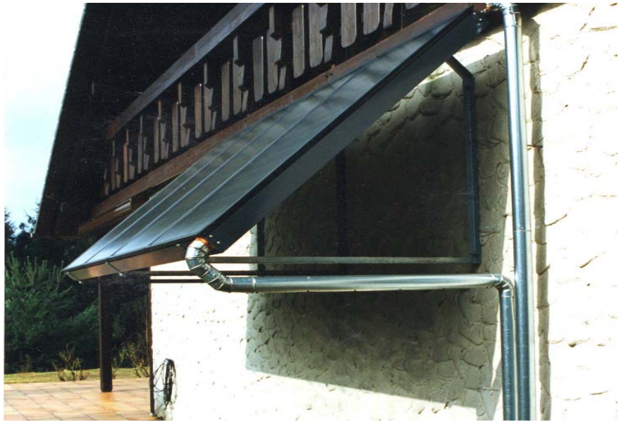
Ein an der südorientierten Giebelwand montierte Flachkollektoranlage. Eine Lösung für Bestandswohngebäude, bei denen die Dachfirste leider vorwiegend in Nord-Südrichtung orientiert sind.
