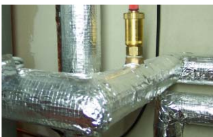
Das Dämmmaterial der Anschlussleitungen muss bis über 80° temperaturbeständig sein.
