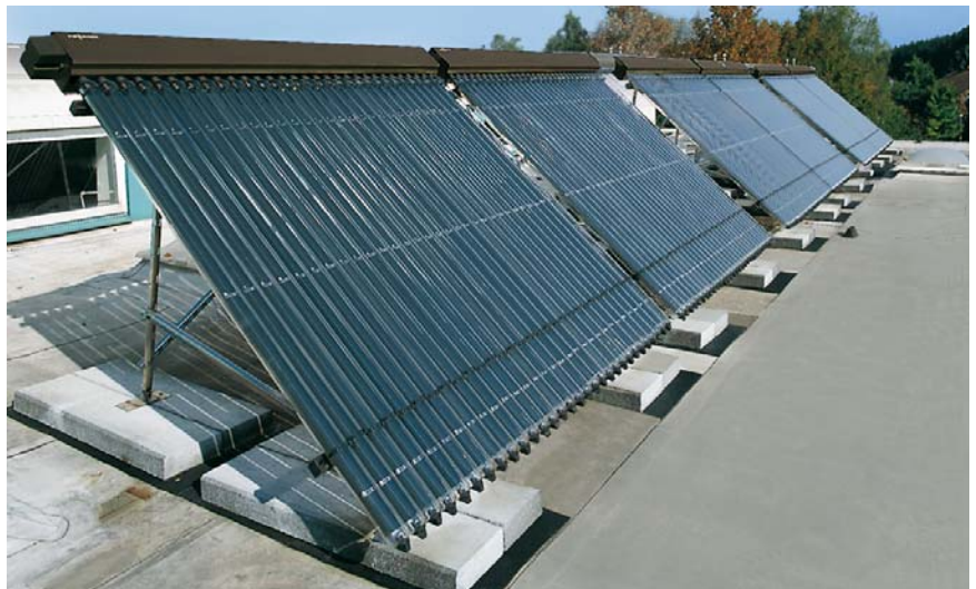
Feld aus Vakuumröhrenkollektoren, aufgeständert auf einem Flachdach
