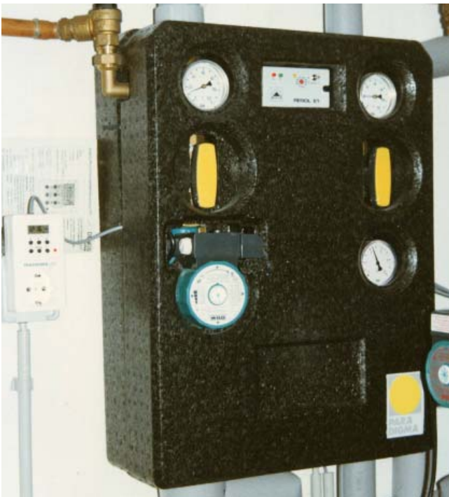
Solarstation: Pumpe, Thermometer, Manometer und Absperrventile sind zusammen in eine Dämmschale eingebaut.
