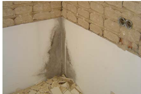
Schimmelbildung hinter einer Küchenzeile
