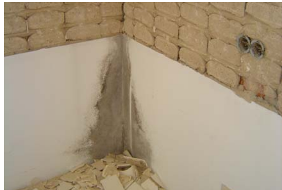
Schimmelbildung hinter einer Küchenzeile
