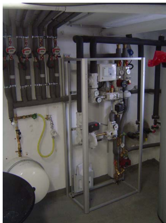
Übergabestation für Fernwärme
