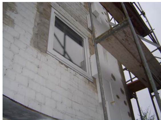
Bündig mit der Außenwand gesetzte Fenster bei neuer Außendämmung zur Minimierung von Wärmebrücken.
