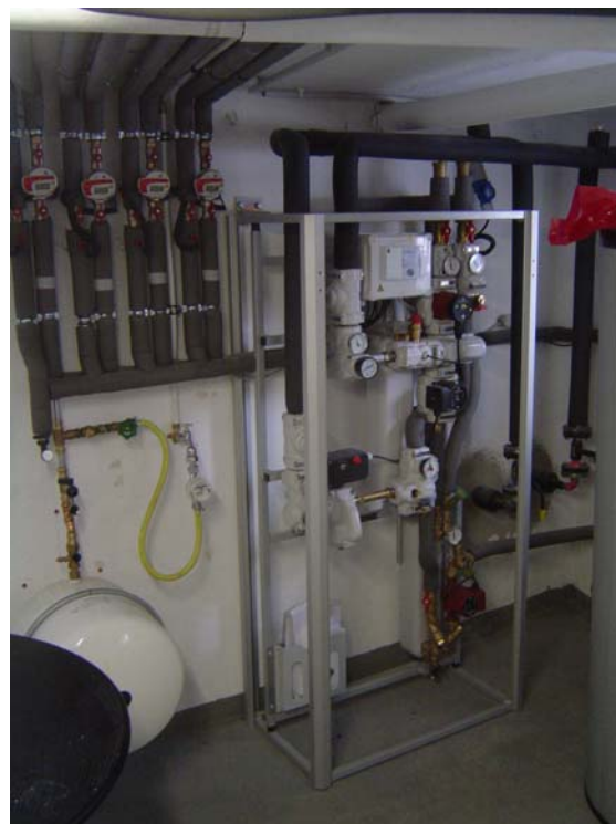
Übergabestation für Fernwärme
