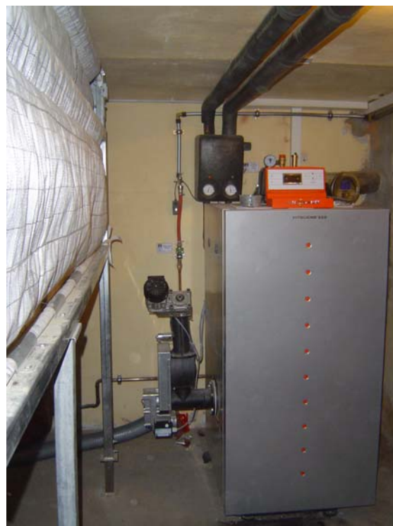
Holzpellet-Heizung in einem Mehrfamilienhaus. Links ein Sacksilo als Vorratsbehälter
