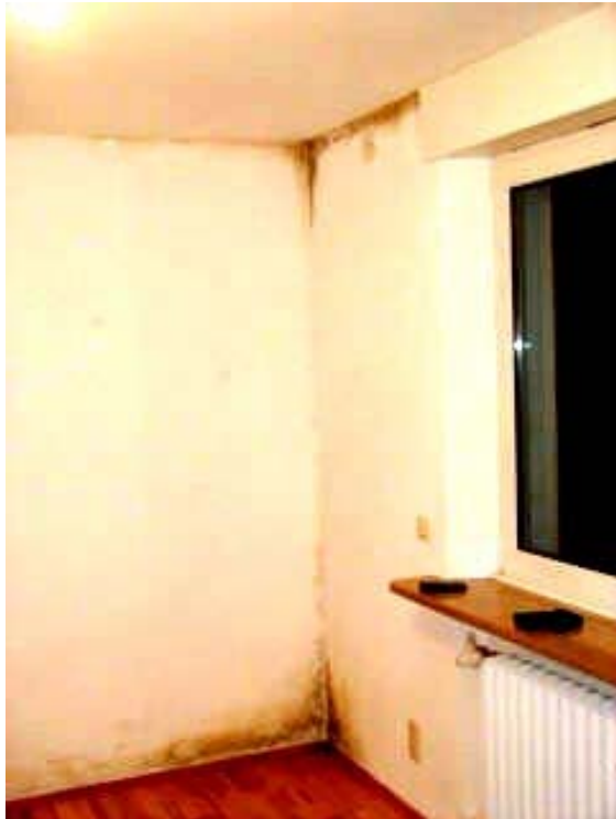
Schimmelbefall an kritischen Außenwandoberflächen
