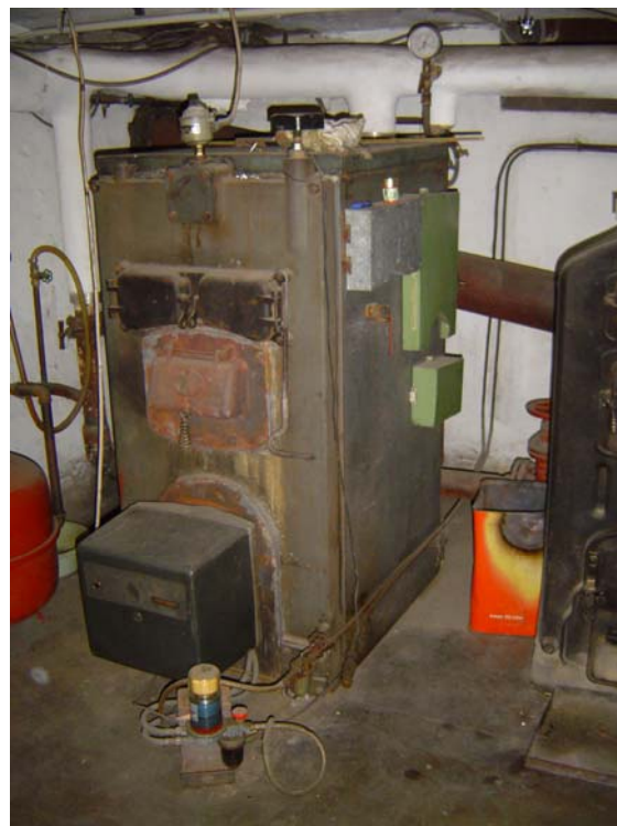
„Musealer“ Kessel im Heizungskeller
