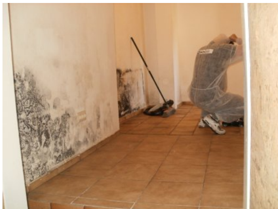
Schimmelbefall an kritischen Außenwandoberflächen
