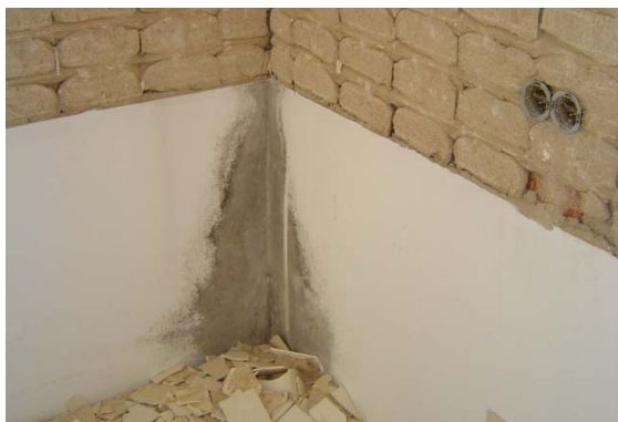
Schimmelbildung hinter einer Küchenzeile.
