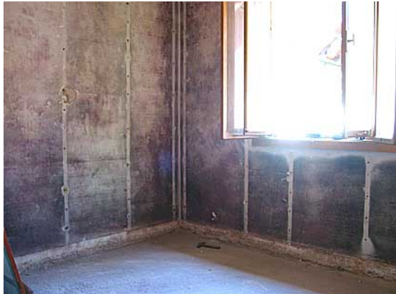
Schimmelbefall hinter falsch ausgeführter Innendämmung
