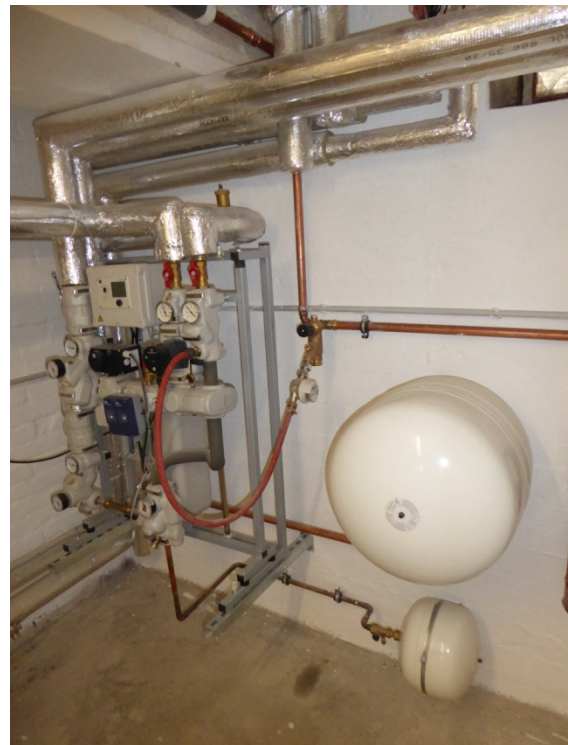
Fernwärmeübergabestation in einem Mehrfamilienhaus
